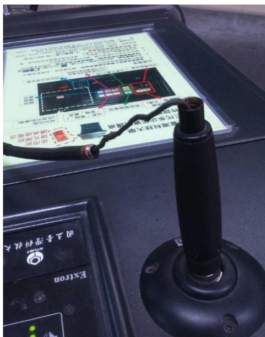
T4-405 桌上麥克風損壞 (2015/05/12)
